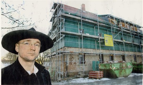
Bauherr: Der Gaschwitzer Zimmermeister Henri Mai saniert das Haus Brunnengasse 1 mit Fördermitteln der „Sozialen Stadt“. Im Sommer soll Einzug sein. Foto: André Kempner
